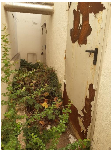
Figura 6 Ingresso centrale termica scuola Brig. Antonio Cezza
