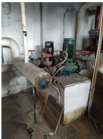
Figura 10 Foto della coibentazione per possibile presenza di amianto
