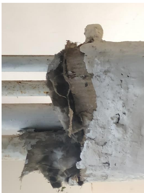
Figura 19 Possibile presenza di amianto
