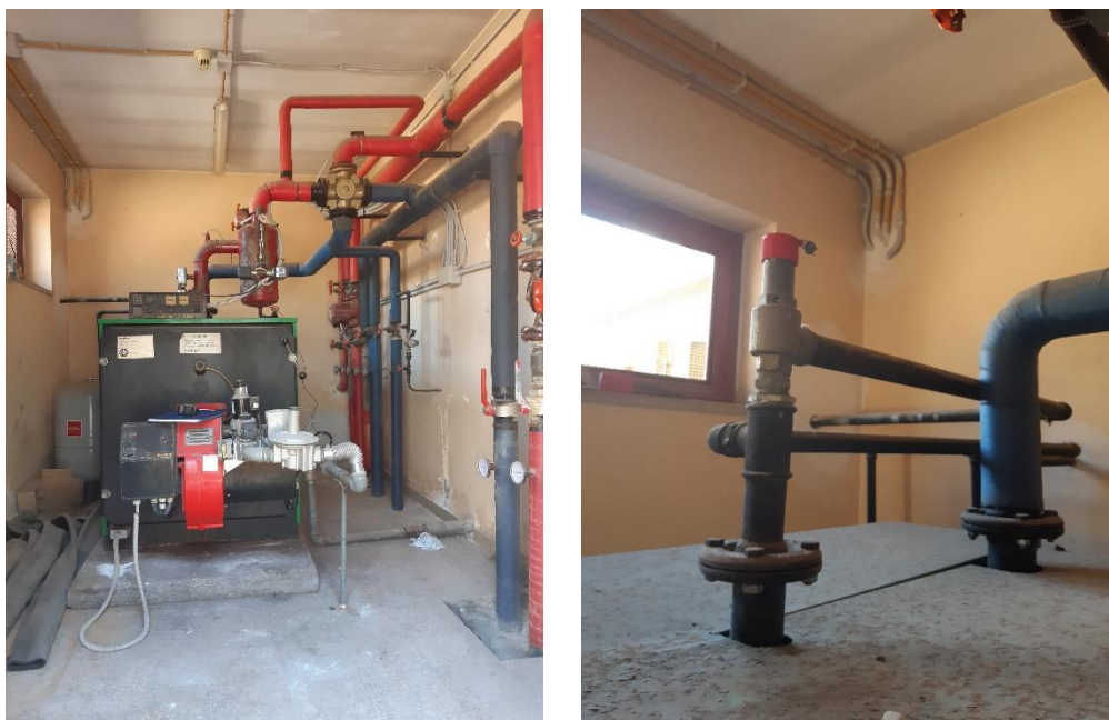
Figura 17 Centrale termica scuola "G. Beltrani"
