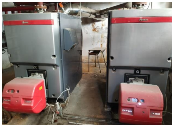
Figura 8 Generatori di calore attualmente installati nella
