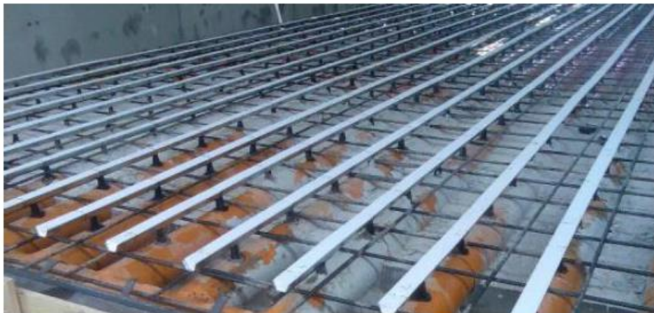
Figura 4: pavimento aerato per biofiltro
